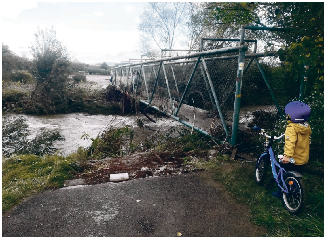
Po jesenných dažďoch stúpila hladina Vláry natoľko, že na cyklotrase posunula lávku, potrhala na nej pletivo a zaplavila polia okolo cyklotrasy smerom do Nemšovej
